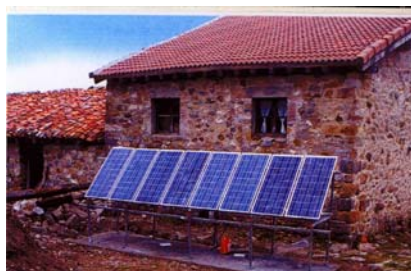
Figura 7. Instalación fotovoltaica aislada (La electricidad solar térmica, tan lejos, tan cerca. Valeriano Ruiz et al)
