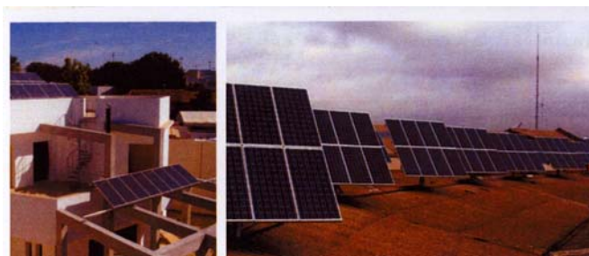
Figura 8. Instalaciones fotovoltaicas de instalación a la red (La electricidad solar térmica, tan lejos, tan cerca. Valeriano Ruiz et al)
